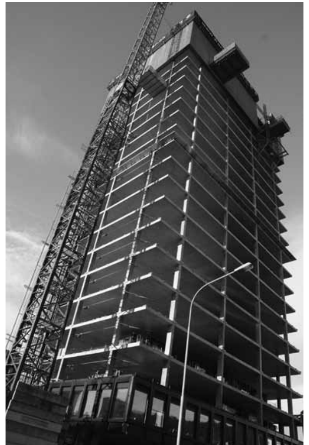
Bei der Fassadengestaltung stimmen die Abmachungen der Peikert Immobilien AG nicht mit den Fassadenelementen überein. Die Bestimmungen der Stadtbildkommission wurden übergangen.
